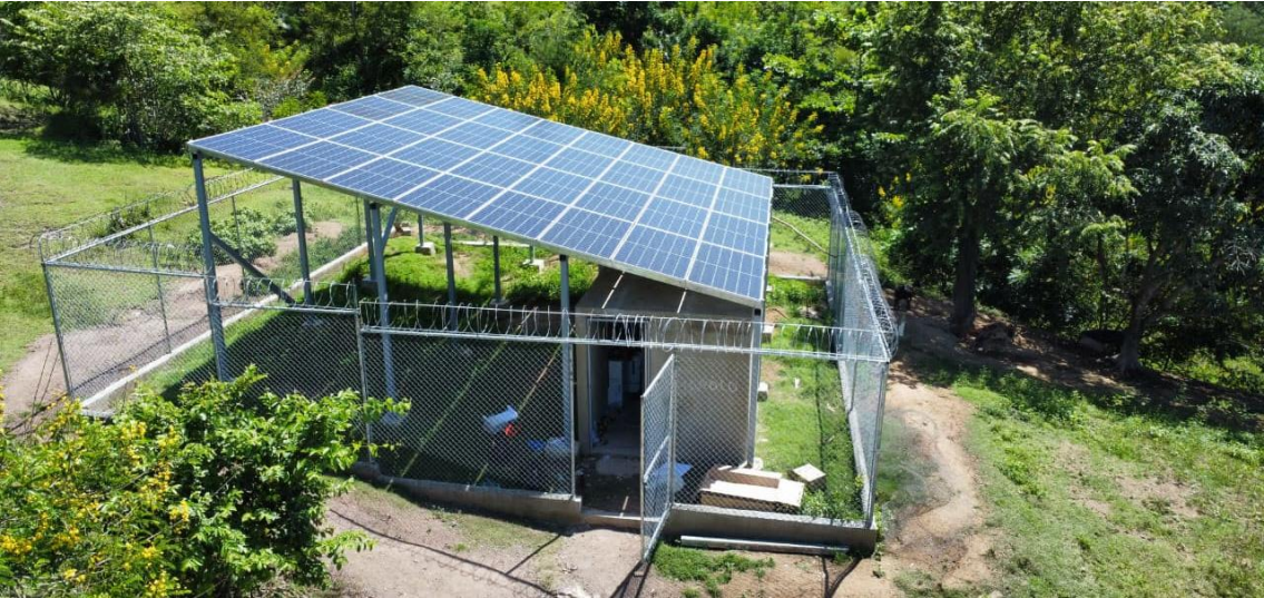
Figura 6. Uno de los núcleos solares fotovoltaicos instalados en Caratá.
