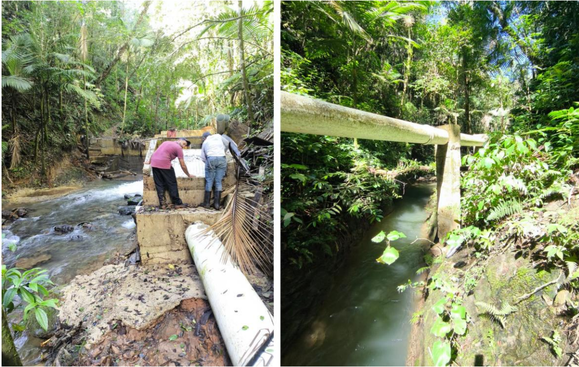
Figura 4. Supervisión de microhidroeléctrica de Guayajayuco (Elías Piña).
