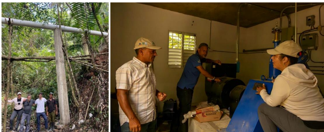
Figura 2. Tramo de la línea de tubería (izquierda) y sistema de generación (derecha) de la microhidroeléctrica comunitaria La Yuca - Florencia.
